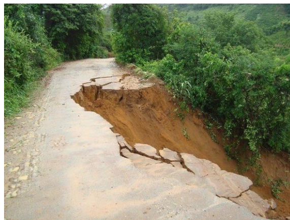
Figura 3-9 - Estradas danificadas pela chuva.
