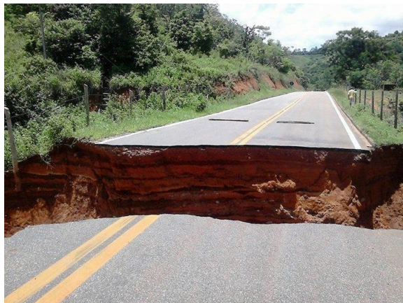
Figura 3-7 - Estradas danificadas pela chuva.
